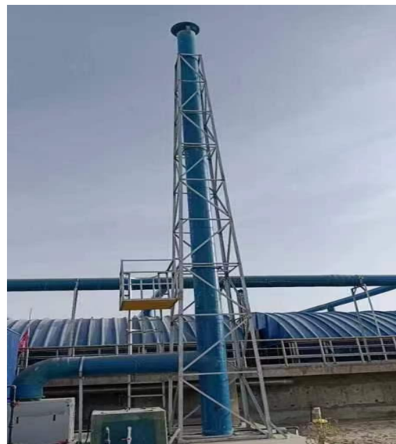
活性炭除臭装置+排气筒
